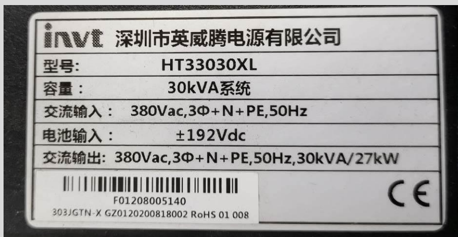
UPS 主机铭牌
