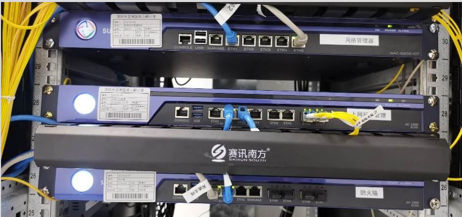
机房动环管理平台、上网行为管理、防火墙
