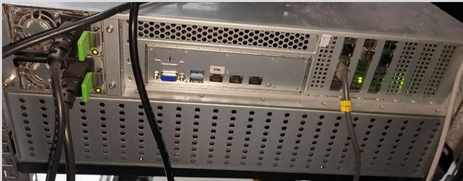
网络存储设备接口、冗余电源
