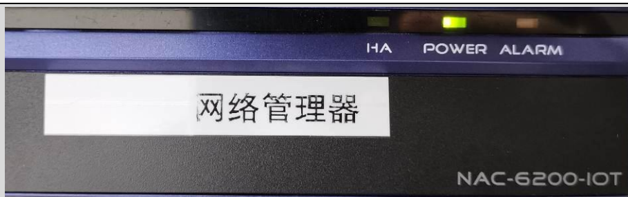
机房动环管理平台型号
