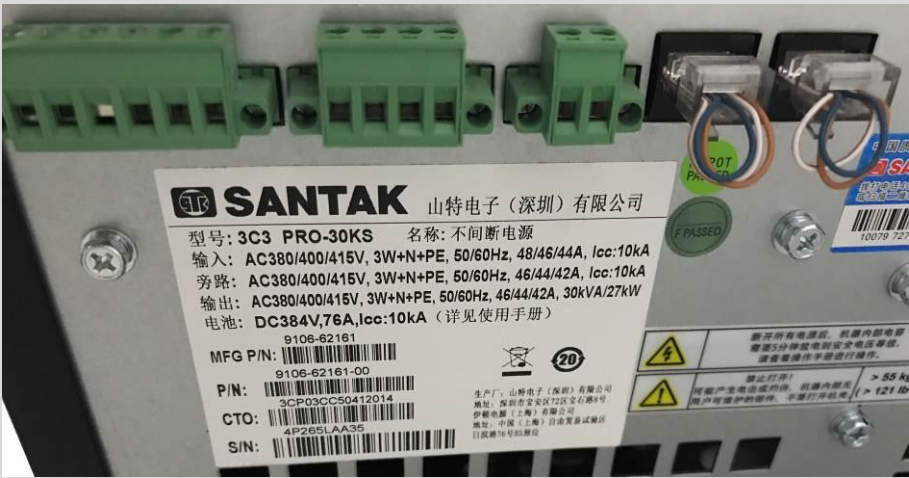
UPS 主机铭牌
