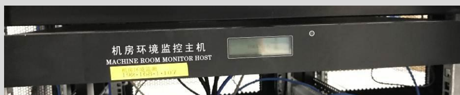
机房环境监控主机
