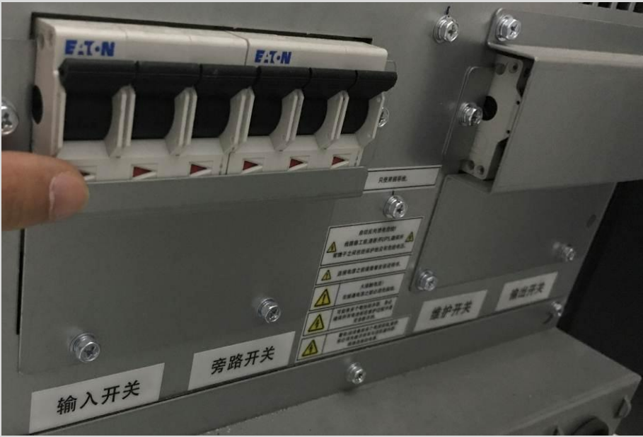
UPS 主机开关
