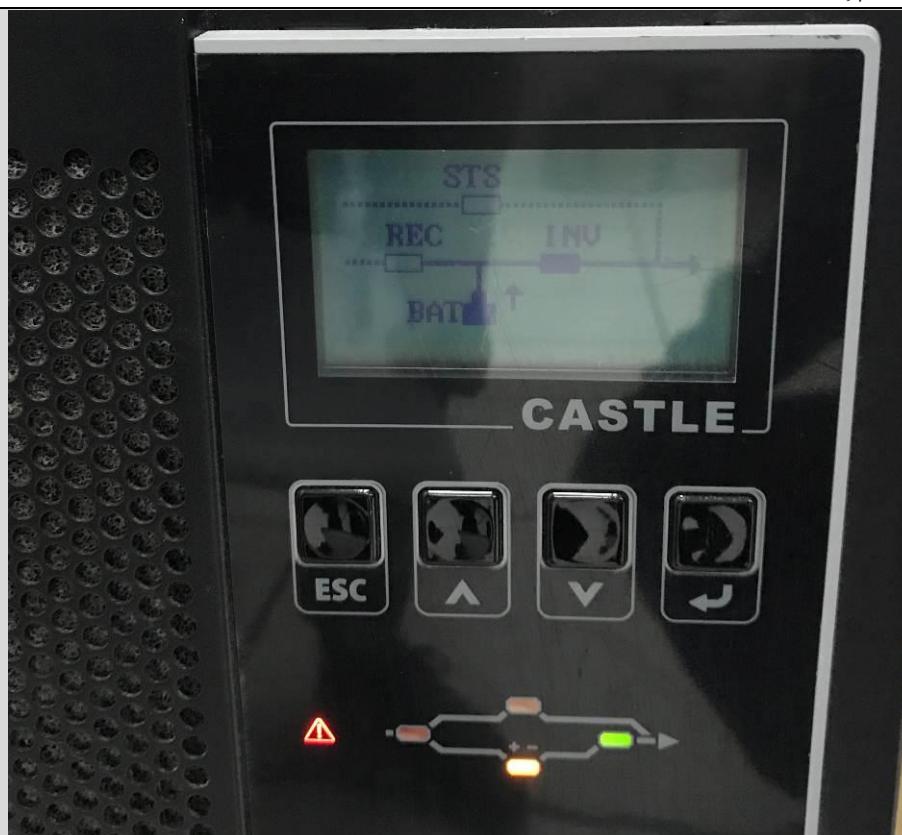
UPS 主机显示屏、控制按钮
