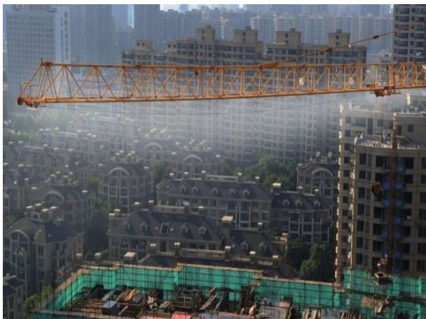
塔吊高空喷淋系统（1）
