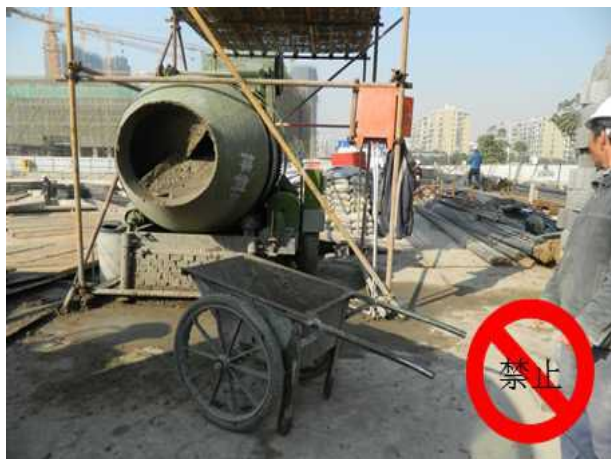
严禁露天搅拌作业（1）
