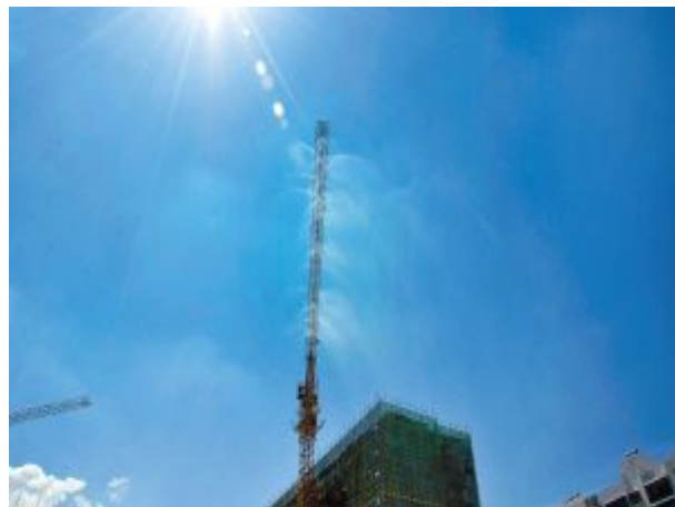
塔吊高空喷淋系统（2）
