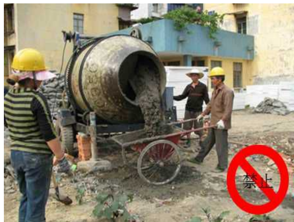
严禁露天搅拌作业（1）
