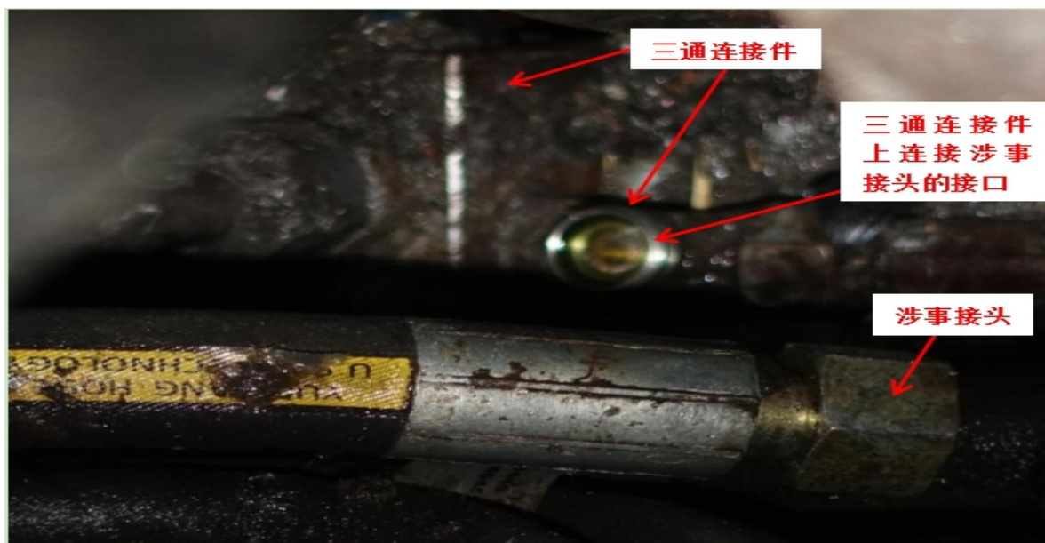
图 10：涉事接头已拆卸
